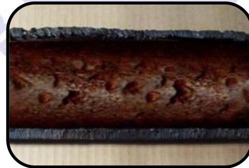
Desgaste por corrosión
